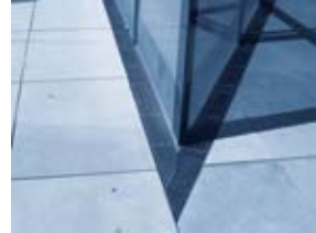
Pinakothek der Moderne [Entwässerungsroste]
